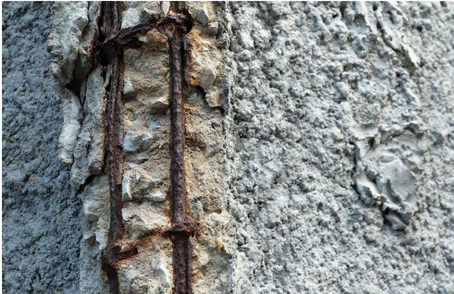
图 4 混凝土墙面腐蚀
